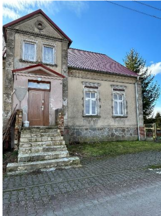
Źródło: Materiały własne Miasta i Gminy Torzym - Wnętrze świetlicy w Walewicach przed remontem oraz widok zniszczonych schodów
