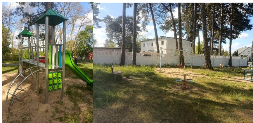
Źródło: Materiały własne Miasta i Gminy Torzym - Prace montażowe i gotowy zjazd linowy na placu zabaw w Gądkowie Wielkim
